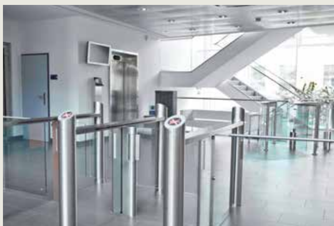
Impianti per l'accesso fisico
