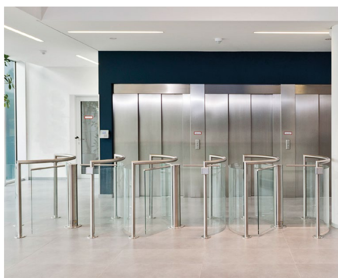
03 Soluzione di sicurezza di fronte all'ascensore
