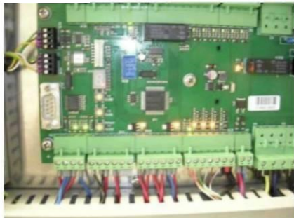
Модуль ввода "I1" к –X101 (IN1 расположен в правом нижнем углу)
