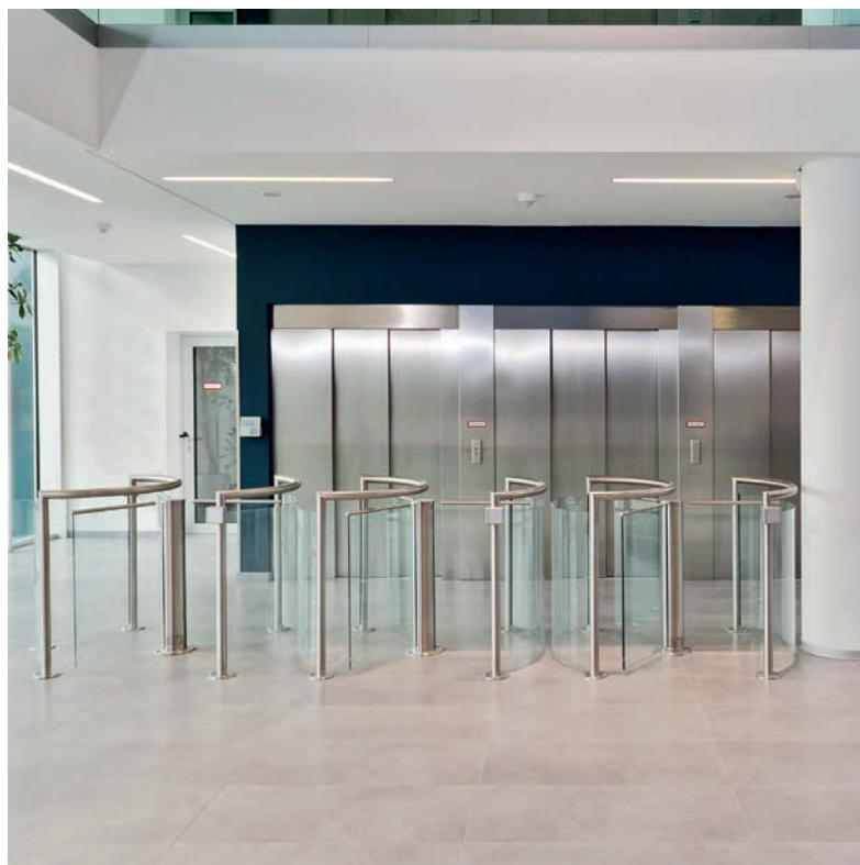
Sikring foran heisene
